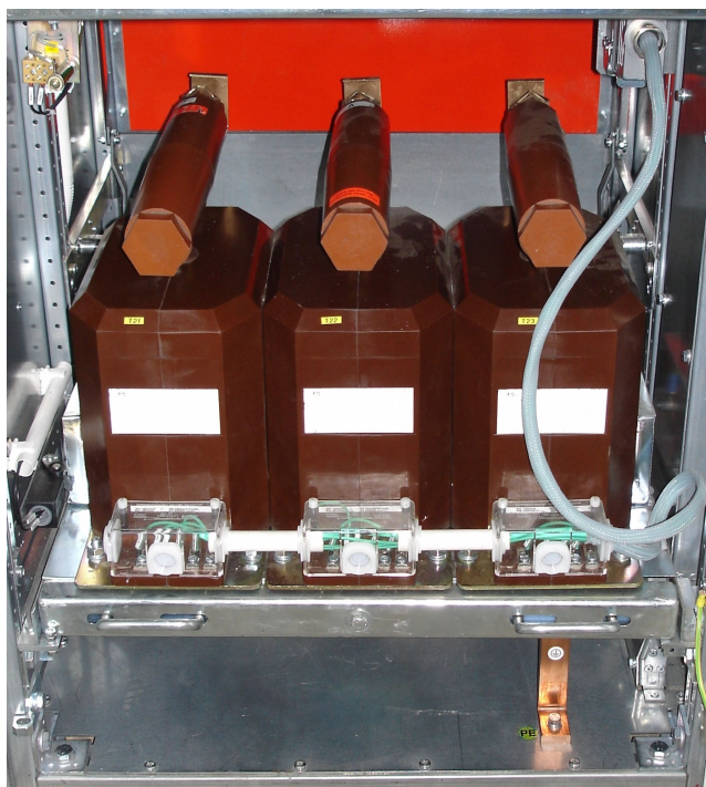
Rys. 4. Przekładniki napięciowe w polu pomiarowym
